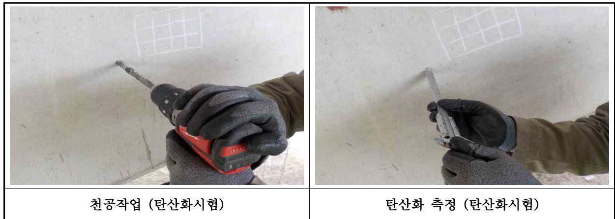
<그림 3.2.10> 탄산화시험 위치도 및 현황
