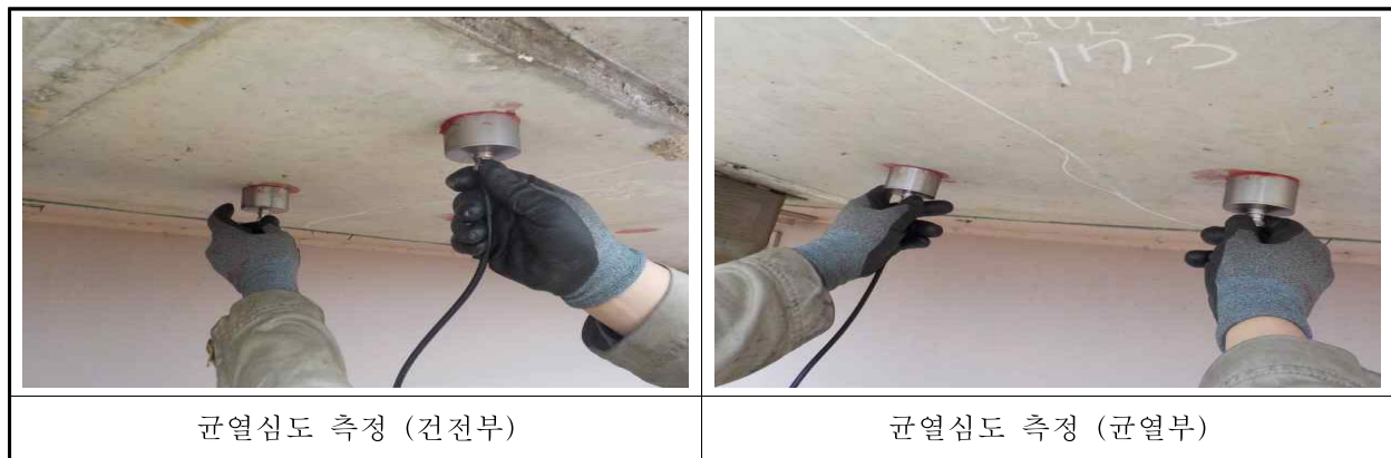
<그림 3.2.9> 균열깊이 측정 위치도 및 현황
